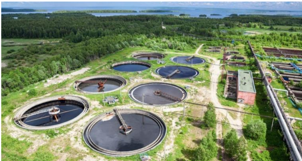
Ilustración 7. Representa los decantadores de una planta depuradora (EDAR). Tomada de Ágora (2021)
